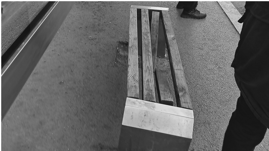
候车凳有一根木条断裂。
