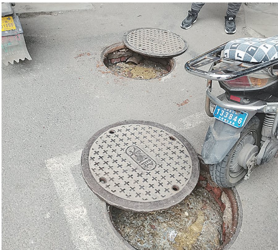
下水井堵塞严重,造成单元排水不畅。
