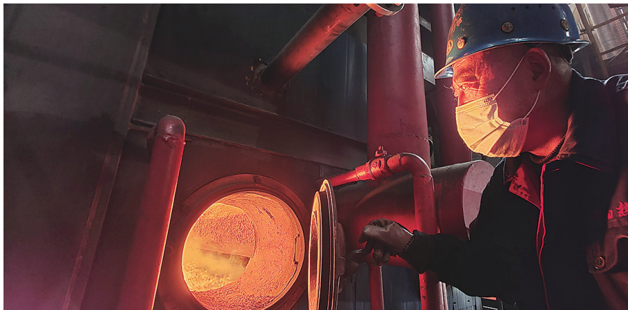
昨日,在沈阳浑南热力2号热源厂,工作人员正在观察锅炉运转情况。
