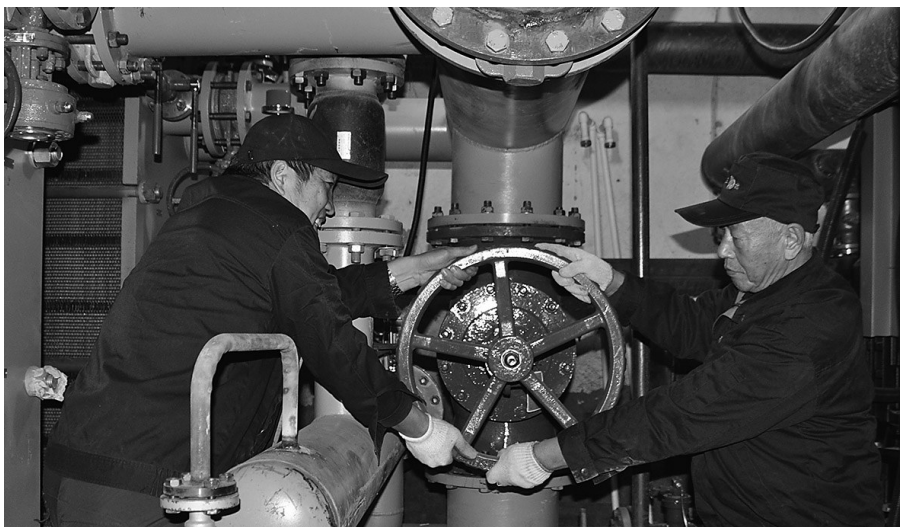
沈阳供暖系统进入热态试运行阶段，供暖系统逐渐升温。
