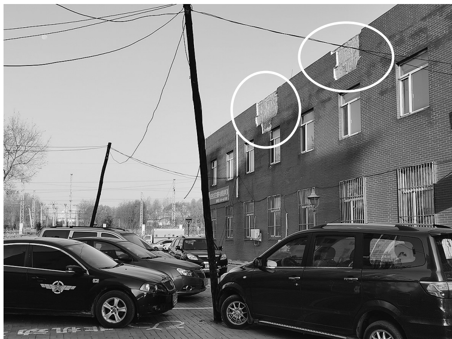
两根线杆往不同的方向倾斜,办公楼两处墙皮脱落。
