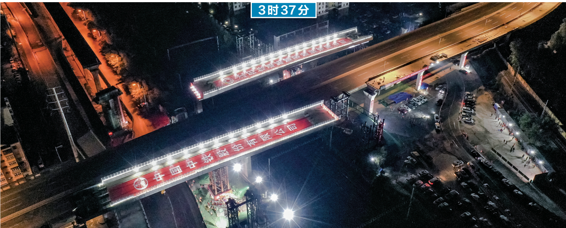
10月21日凌晨,历时90分钟,胜利大街揽军路跨铁路转体桥工程两座新建匝道桥同步转体。
