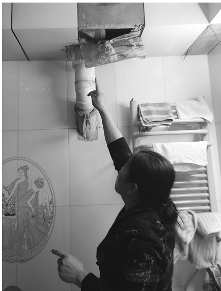
胡女士家厕所顶棚下水管处漏水。
