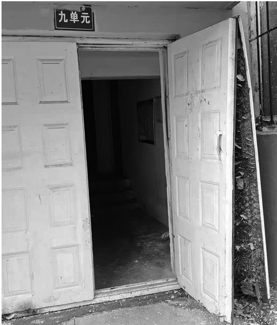
于洪区西湖小区50-1号九单元的门开裂急需维修。
