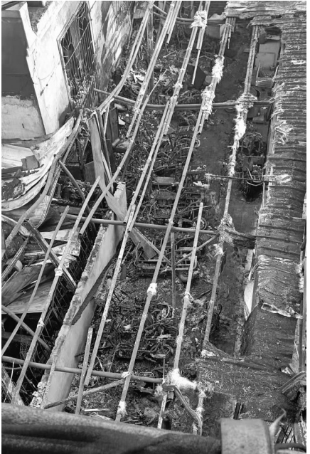
被烧毁的车棚内有大量电动车残骸。
