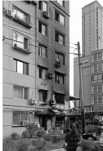
车棚旁居民楼窗户不同程度被烧毁。
