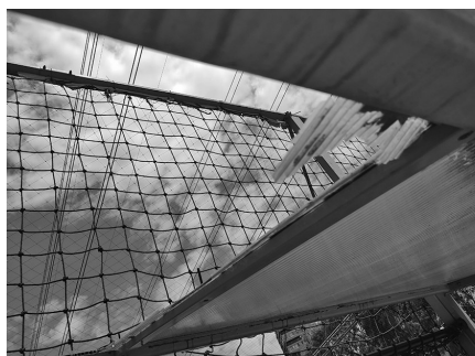
遮阳棚的玻璃瓦破损。
