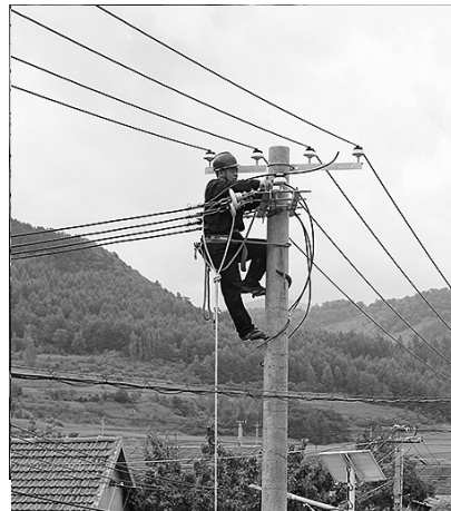
供电人员正在检查电路。本溪供电公司供图
