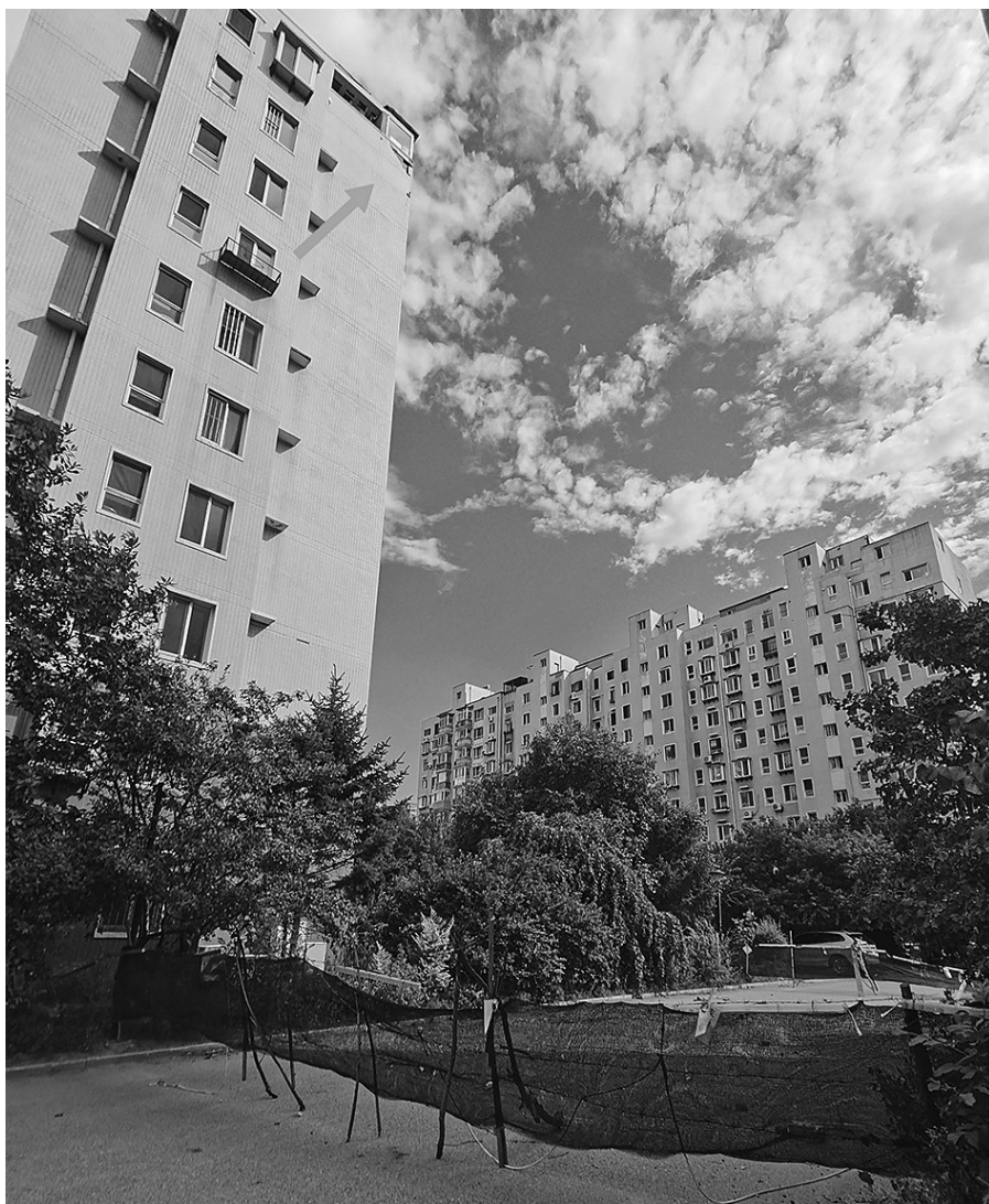
34号楼有部分墙砖脱落，楼下有一条宽约十米的柏油路，两道护网横在马路中间，将整条路彻底阻断。
