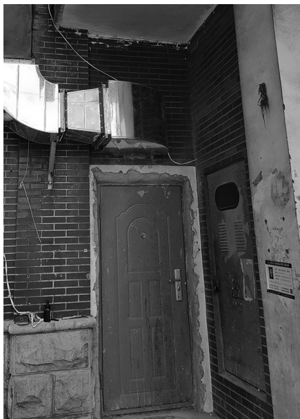
右侧新开门和排烟管道紧挨变电箱。
