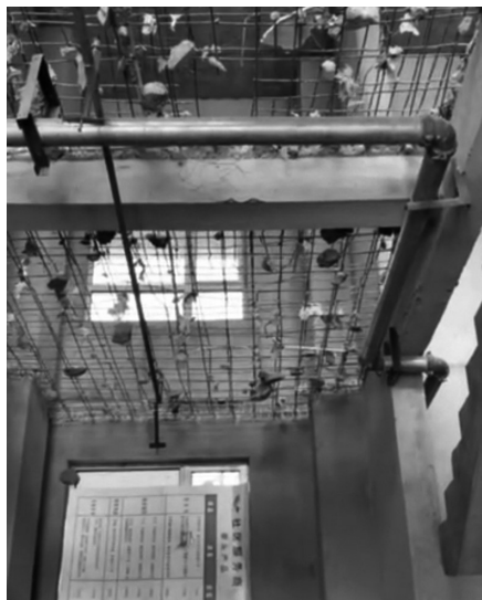
门市的楼层地面已经被砸得钢筋外露。
