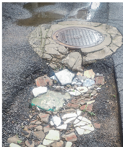
井盖两侧已塌陷,存在安全隐患。
