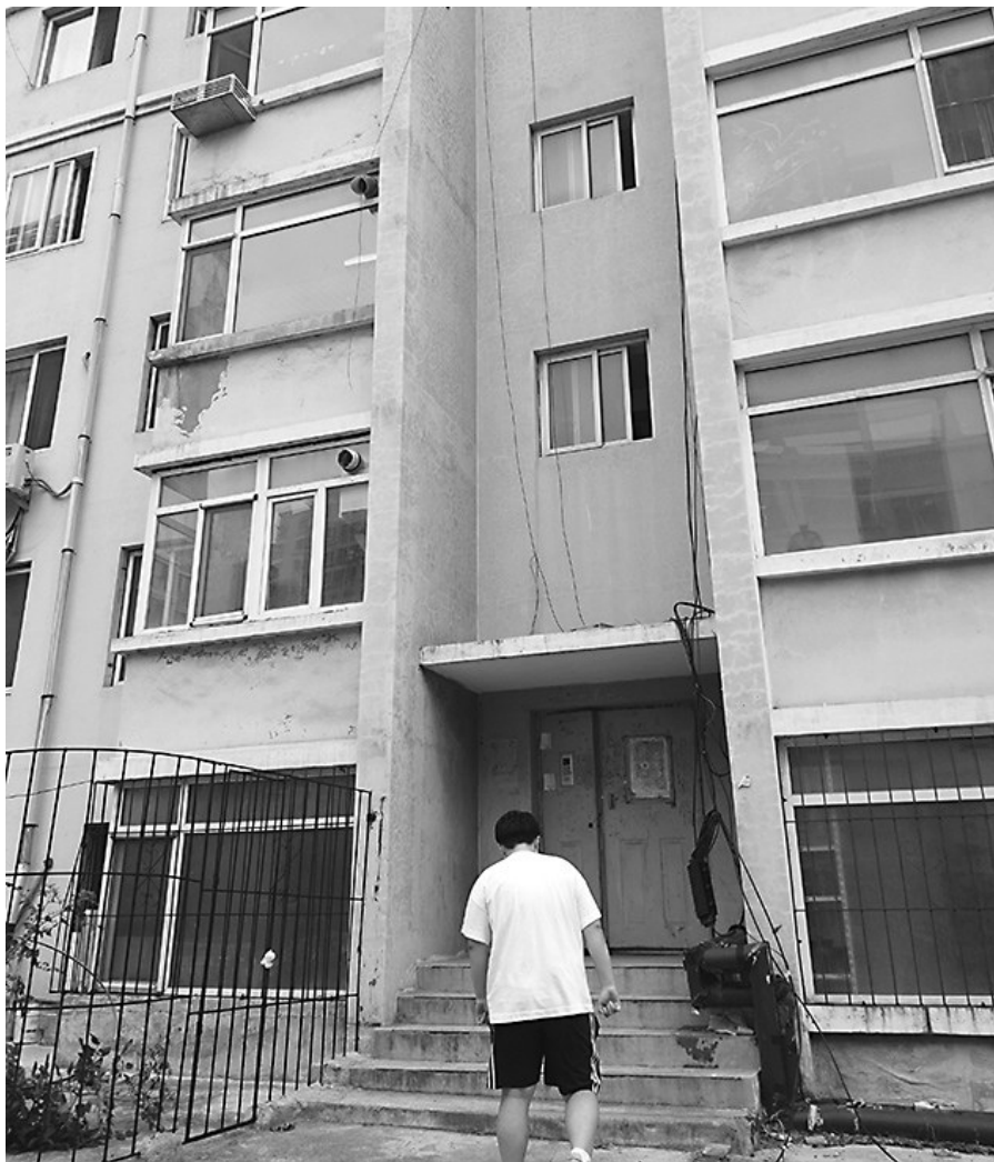
该小区12号楼一单元的居民近20天用不上燃气。
