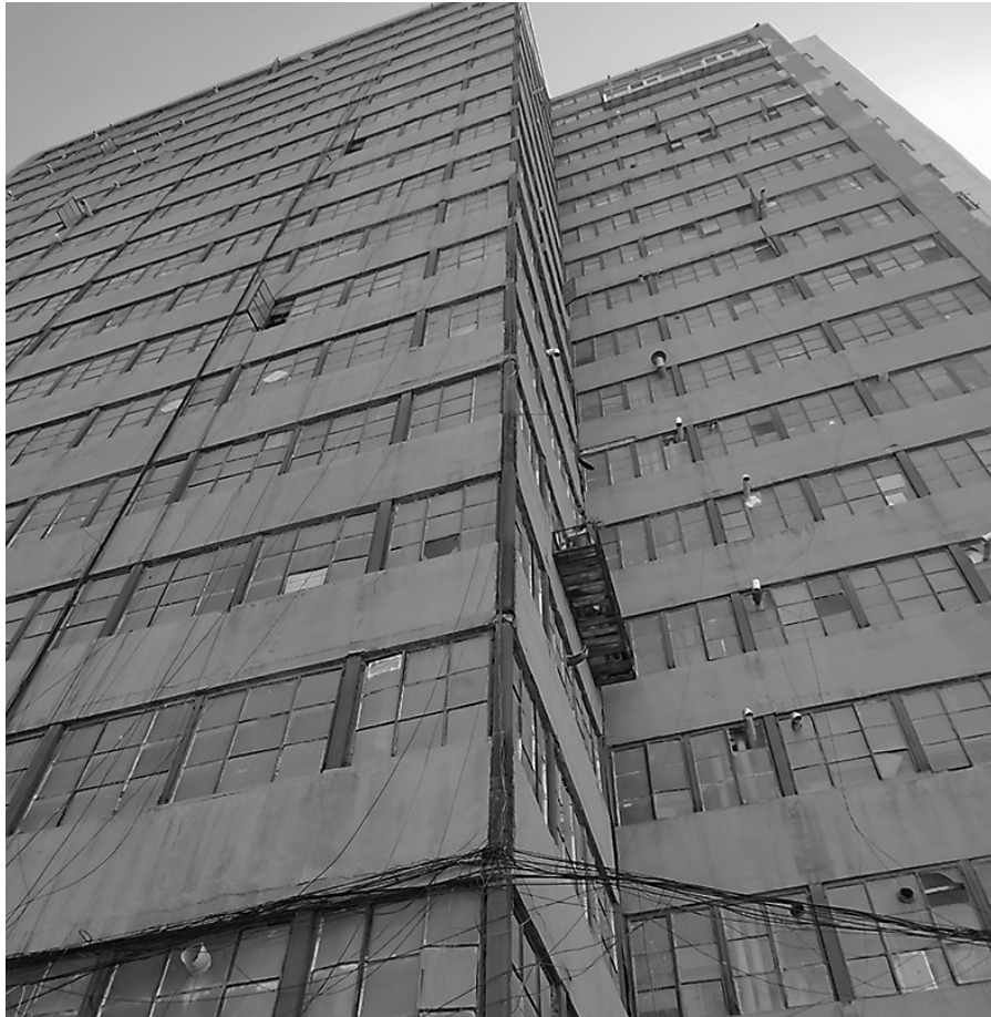
楼外侧全部是公共走廊的玻璃窗,有很多都已经破损了。
