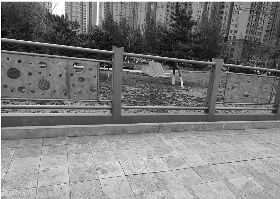
和安桥南端栏杆缺失一块护板。
