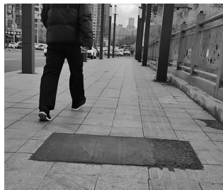
和安桥上的大坑已被修复。
