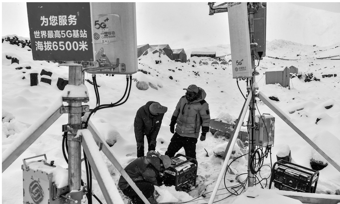
2020年5月21日,在海拔6500米的珠峰前进营地,中国移动工作人员在调试5G基站。
