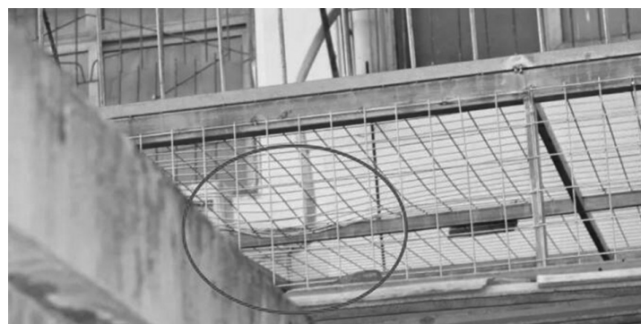
防护网被砸出凹陷。
