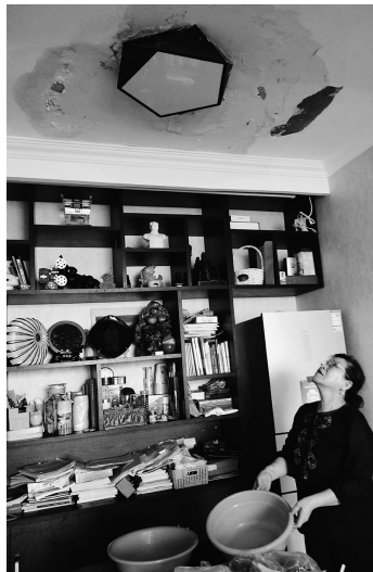
家住和平区四平街社区的李阿姨一直被屋顶漏水所困扰。
