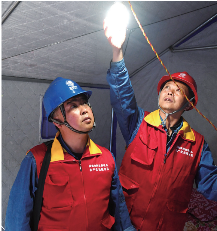
在临时集中安置点,国网陇南市武都区电力公司的抢修人员在帐篷里检查照明设备和电路。
