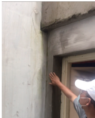
地下配电室外墙已经出现了青苔。辽沈晚报记者 李毅 摄
