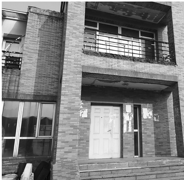
前物业工作大楼大门紧锁，老物业部分工作人员仍在此处办公。
