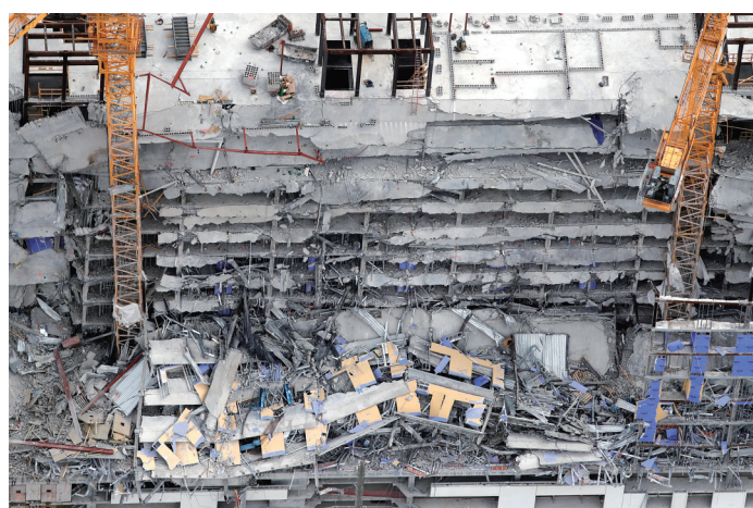
10月12日在美国新奥尔良拍摄的发生部分坍塌的酒店。
