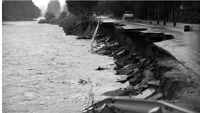
8月11日，山东省临朐县辛寨镇一处路段被暴涨的河水冲塌。
