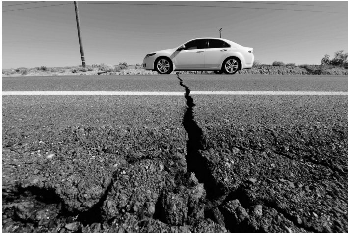
7月4日在美国加利福尼亚州特罗纳附近的一处被地震损坏的道路。新华社发
