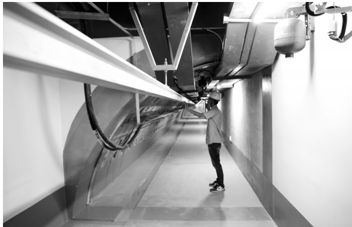
工作人员在地下管廊内查看设备运行状况。
