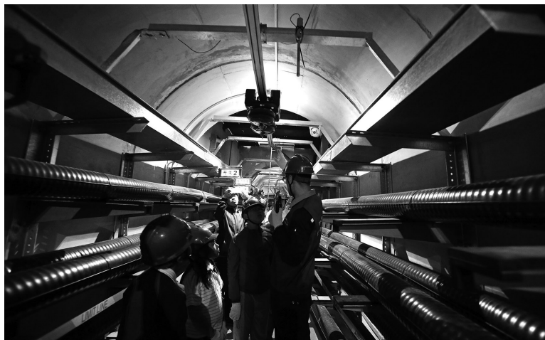
辽沈晚报小记者了解高压电缆运行常识、电缆智能监测设备,观看智能巡检机器人运行演示。白跃红 摄
