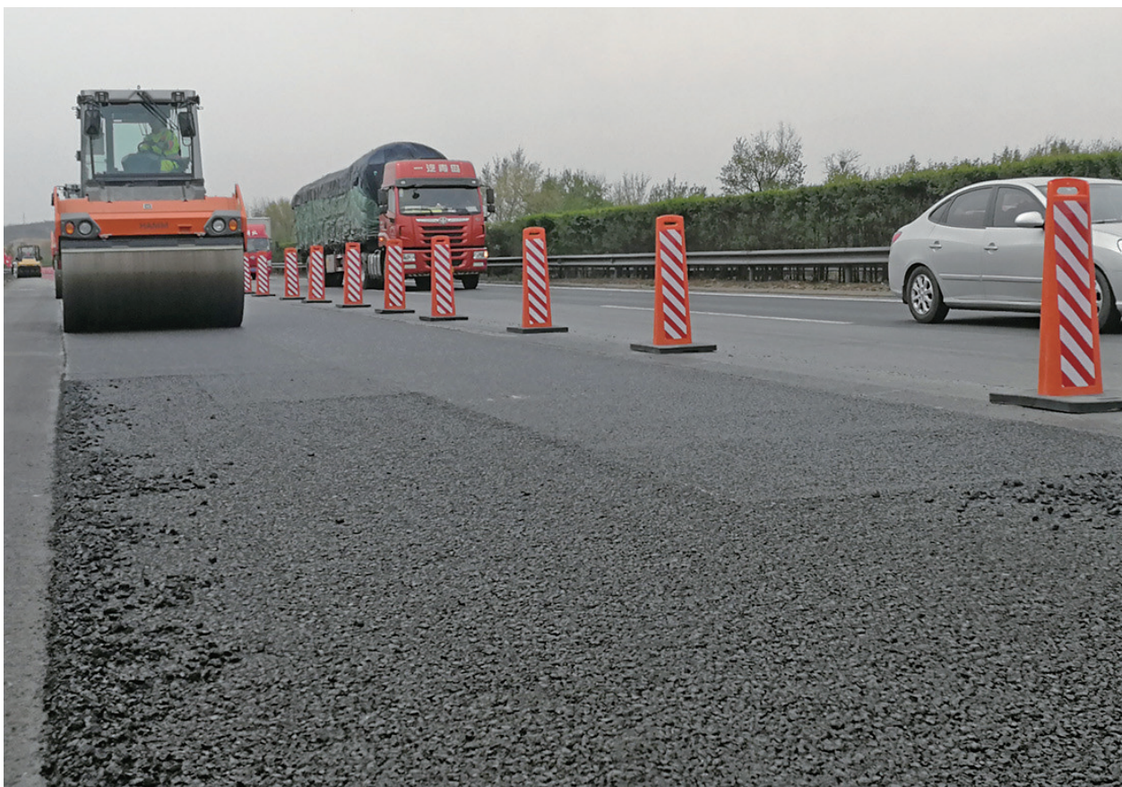
沈山高速一处维修路段,施工单位对边车道进行封闭施工,车辆在超车道和中车道上正常行驶。辽沈晚报、聊沈客户端记者 张阿春 摄
