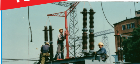
1988年220千伏虎石台变电站
