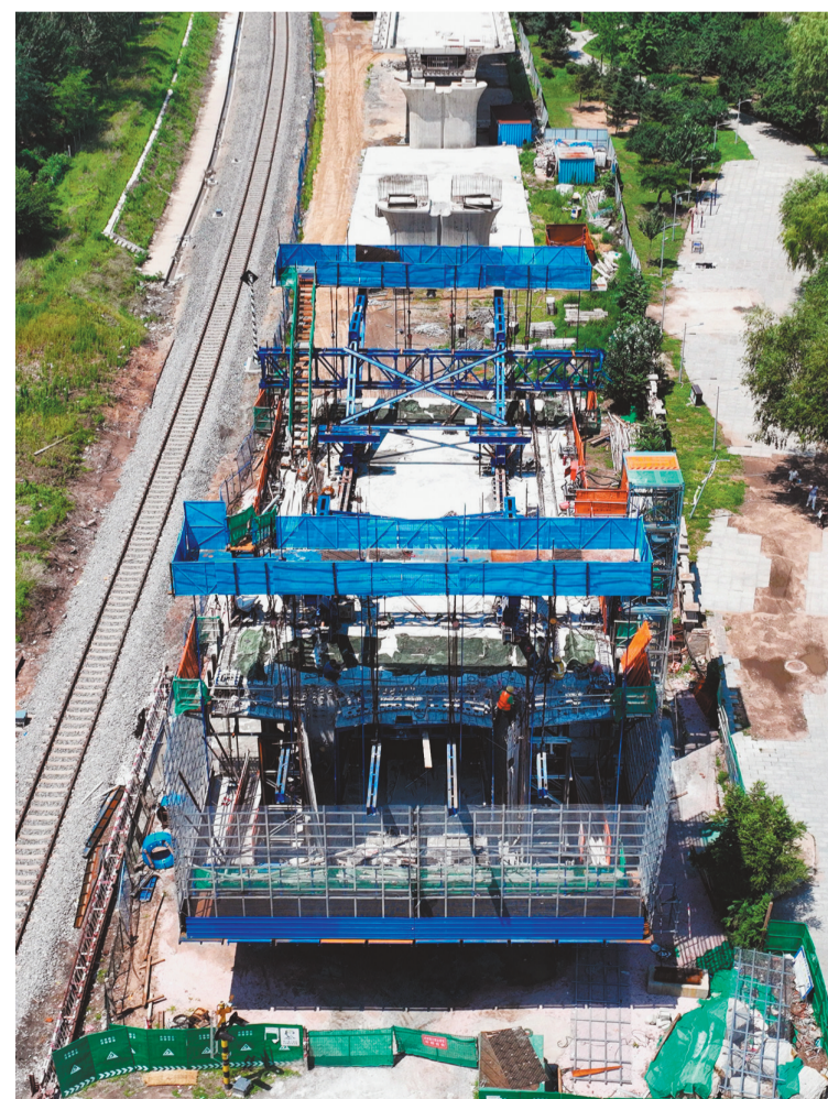
7月11日,在沈白高铁的重要施工区域——沈阳沈东特大桥施工现场,工人正紧张有序地进行底板板的施工。沈白高铁建成通车后,沈阳至长白山最短运行时间将缩短至1.5小时,对促进区域经济社会高质量发展具有重要意义。图为沈白高铁沈东特大桥施工现场。 本报记者 赵敬东 摄
