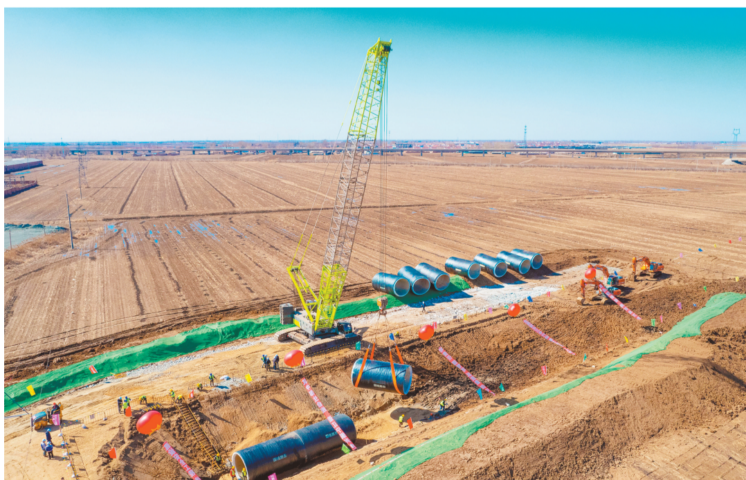
图为我省中南部地区供水工程施工现场。本报记者 韩宇浩 摄
