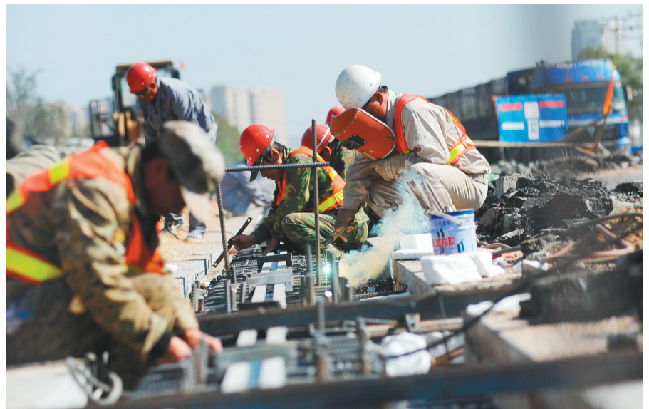
鞍山加快现代化基础设施建设,图为施工人员正在南三环进行道路改造。
