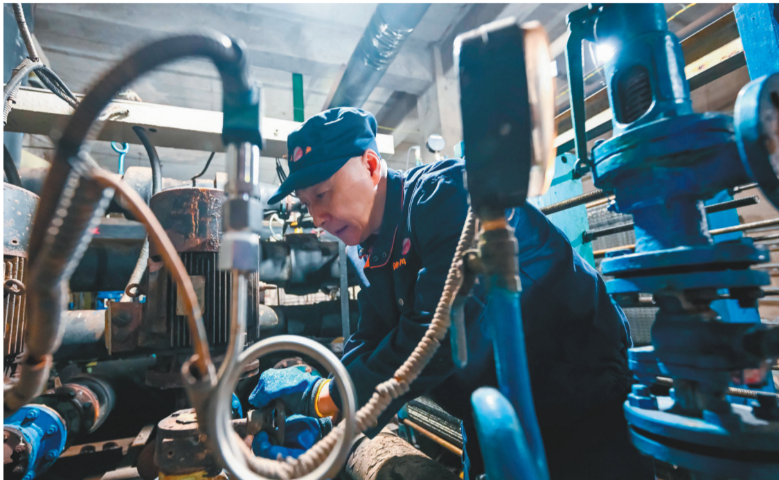
气温骤降,沈阳第三热力供暖有限公司换热站工作人员在查看设备运行情况。 本报记者 查金辉 摄
