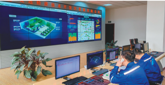
11月23日,大连经济技术开发区供热有限公司监控运行数据,保障居民供暖。 本报特约记者 朴峰 摄
