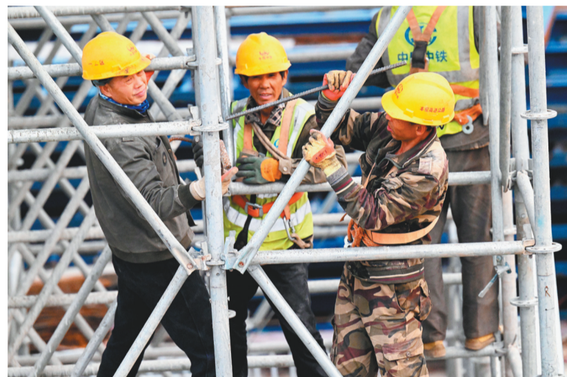
本桓高速公路跨太子河大桥建设现场，施工人员正在桥墩上紧张作业。
