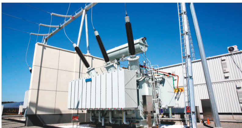
抚顺矿区西舍场200MW光伏发电项目升压站。 张 昭 摄
