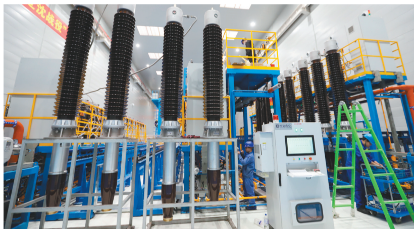
特变电工沈阳变压器集团有限公司特高压套管研发制造基地。本报记者 杨靖岫 摄
