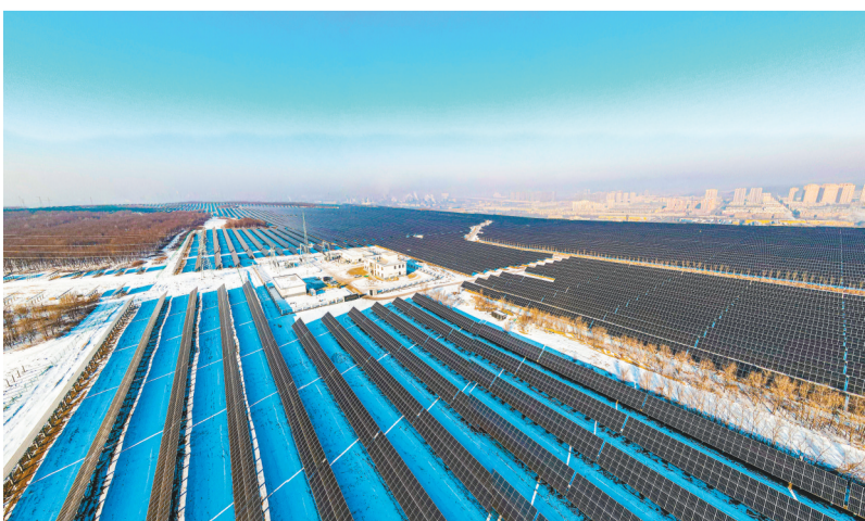
抚顺矿区西舍场光伏发电项目开始并网发电。
