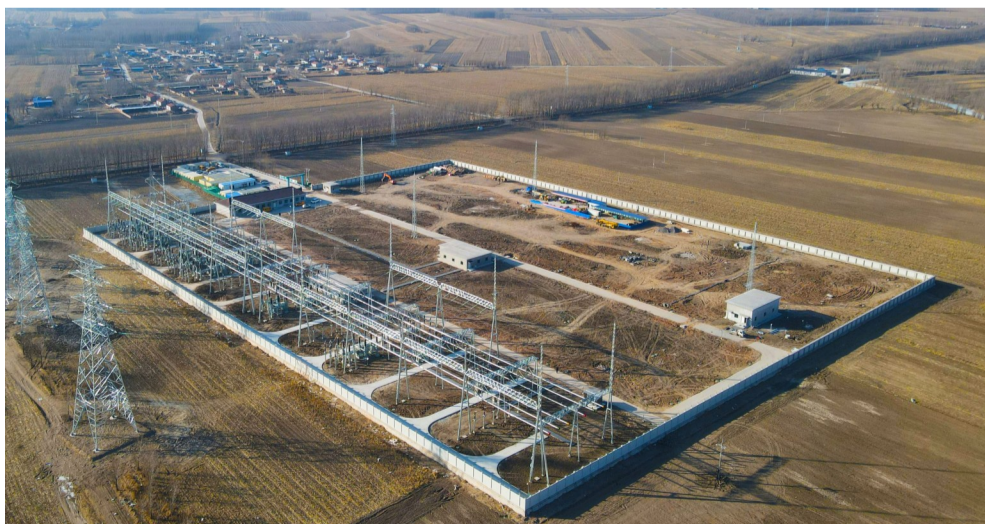
阜新 220 千伏丰田开关站。
