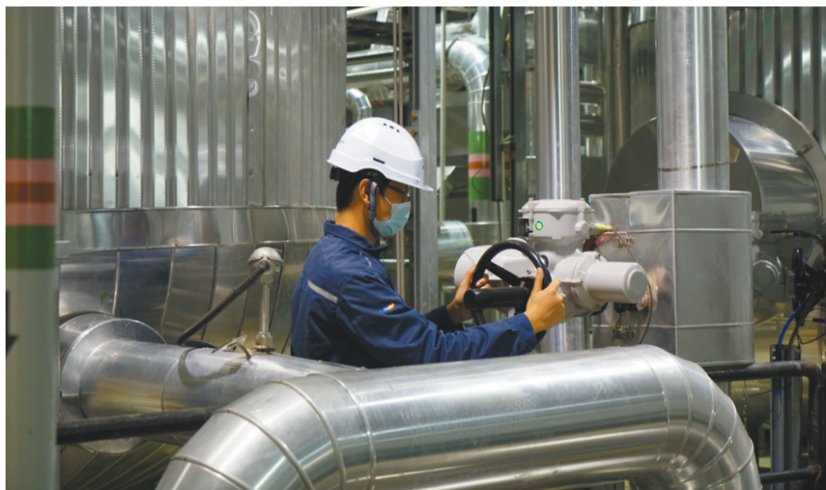
工作人员在红沿河核电二期7ME换热首站进行供热操作。
