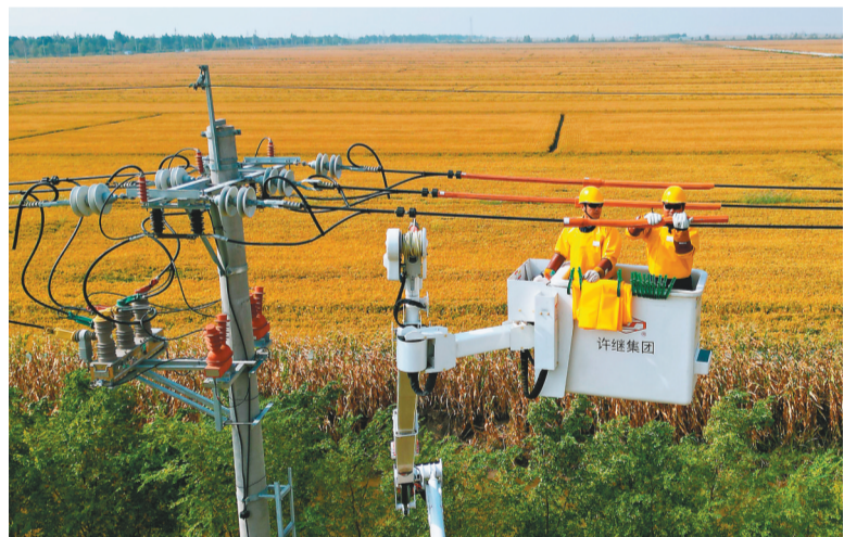
盘锦供电公司员工进行带电抢修作业,保障国家5A级旅游景区红海滩国家风景廊道周边可靠供电。
