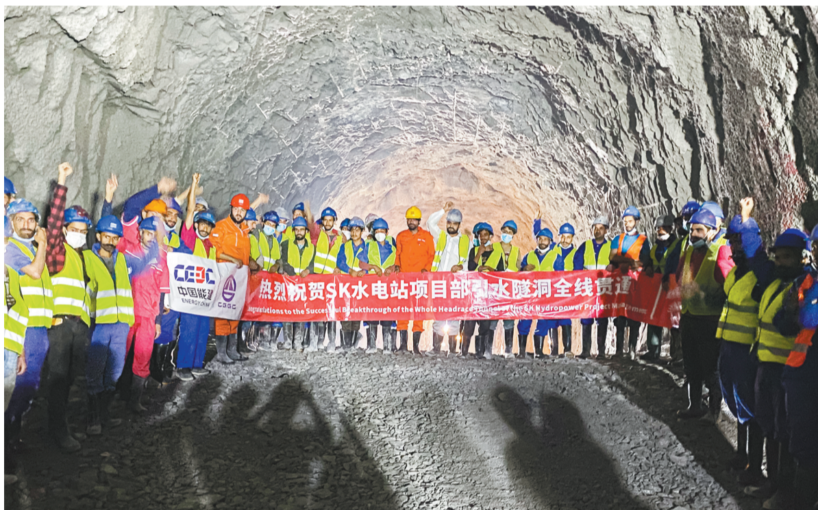
9月10日,项目人员在巴基斯坦苏吉吉纳里水电站项目引水隧洞贯通处合影。由中国能建葛洲坝集团海外投资公司投资建设的巴基斯坦苏吉吉纳里水电站项目10日实现引水隧洞顺利贯通,为电站投产发电进一步奠定基础。该水电站位于巴基斯坦西北部开伯尔-普什图省曼塞赫拉地区的昆哈河上,是中巴经济走廊优先实施的重点项目之一。 新华社发
