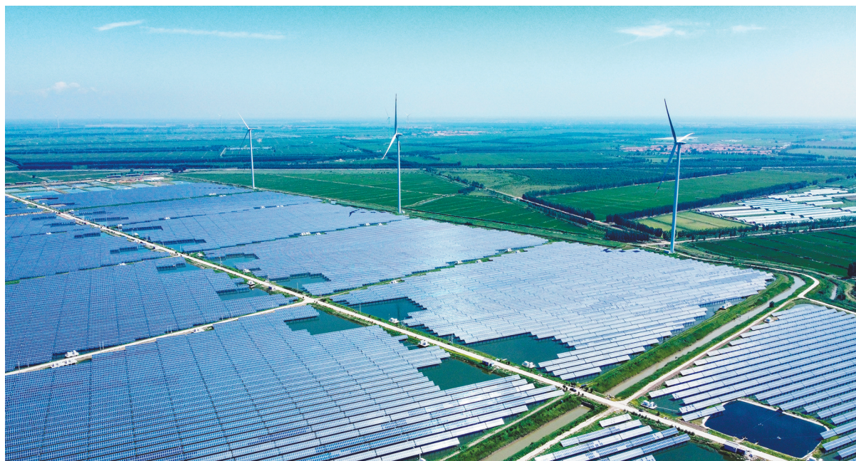
这是在天津市宁河区宁河镇大月河村拍摄的110千伏大月河光伏电站(7月18日摄，无人机照片)。
