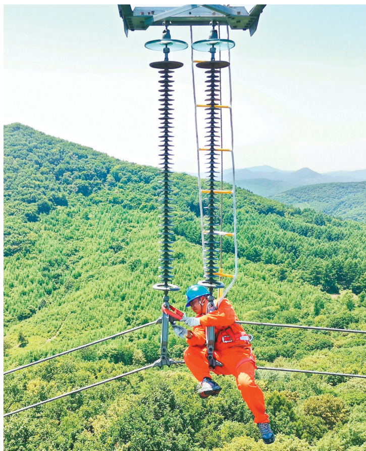
国网辽宁电力员工进行日常线路检修,保障电网设备迎峰度夏期间安全稳定运行。姜云峰 摄
