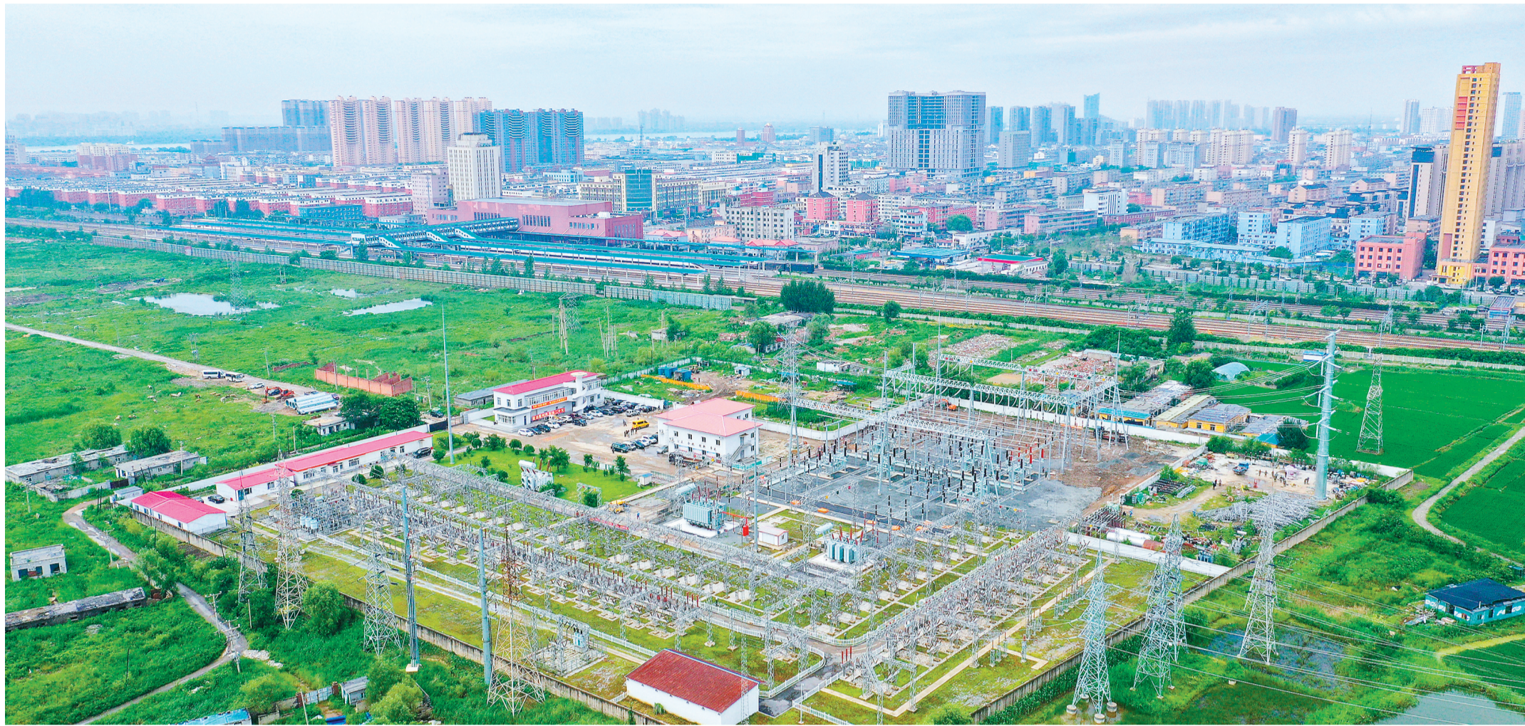
改造后的盘山220千伏变电站。
