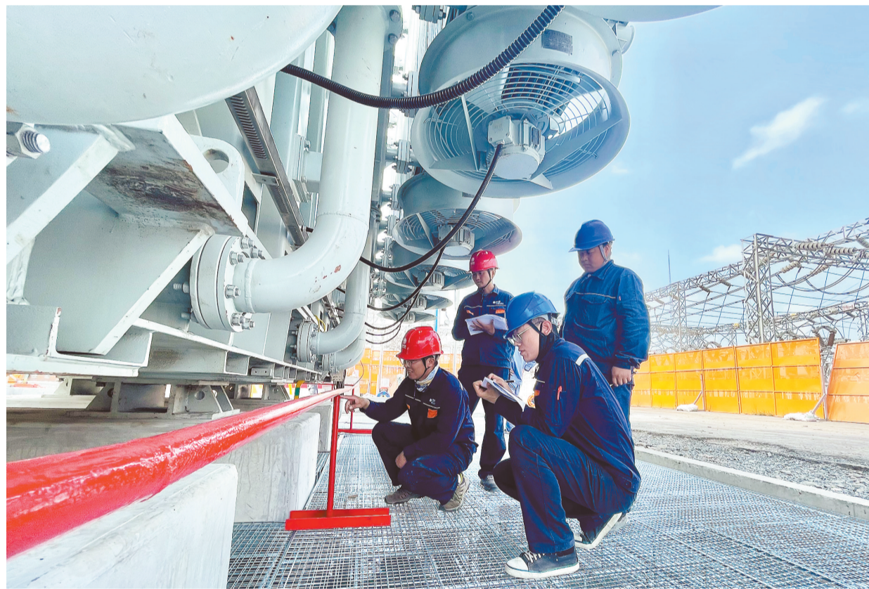
国网辽宁电力员工认真验收新更换的变压器。
