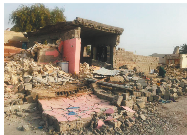
7月2日,伊朗霍尔木兹省萨耶赫·科什村的房屋因地震倒塌。据伊朗法尔斯通讯社报道,伊朗南部2日凌晨发生3次6级以上地震,目前已造成5人死亡,49人受伤。首次地震发生在当地时间2时2分,震中位于伊朗南部霍尔木兹省的哈米尔港附近,震源深度10公里。
