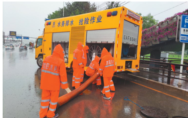
沈阳水务集团200余名职工在岗值守,发现问题及时处理,确保排水设施完好。 本报记者 金晓玲 摄
