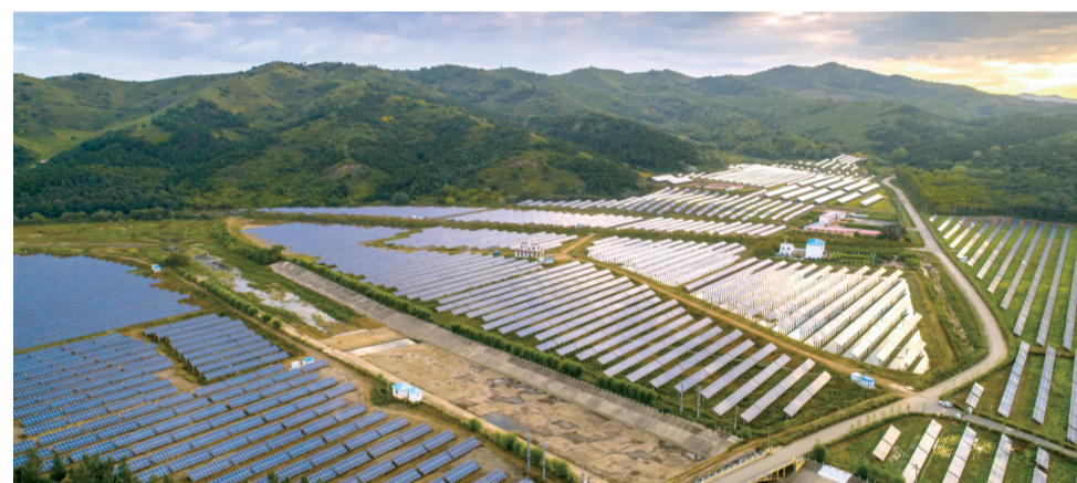
辽水集团光伏发电设施。
