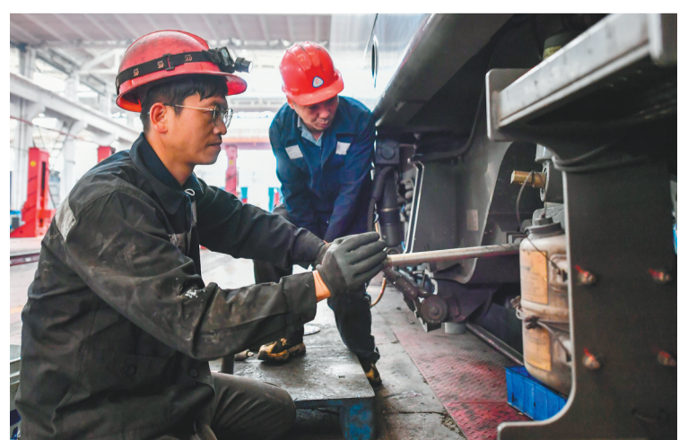
5月12日，中国铁路太原局集团有限公司湖东电力机务段的工作人员在进行检修作业。为保障大秦铁路运输安全稳定，完成任务后的重载列车会在在中国铁路太原局集团有限公司湖东电力机务段进行全面“体检”，工作人员对机车走行部、电路系统、制动系统等关键部位进行深度检修，消除设备安全隐患，保障列车平稳运行。新华社记者 曹阳 摄
